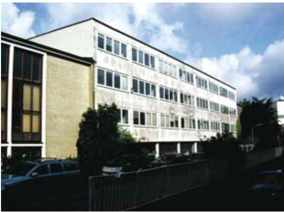
-> Bürogebäude, Parkhaus im EG und TG, Baujahr 1974, Betonskelettbau mit einem Treppenhaus, vorgehängter Fertigteiffassade, Flachdach
